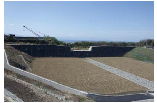
砂防施設(大島町)
