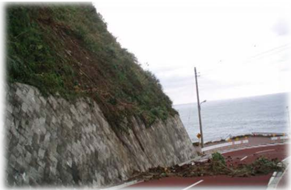
台風14号による現道箇所斜面崩壊 (平成22年10月)
