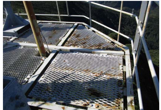
東京都防災行政無線の中継局の劣化(三原山中継所)
