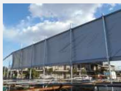
（農薬飛散防止施設）
