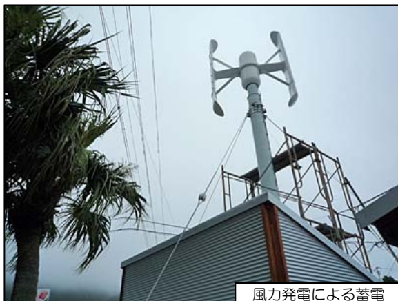
風力発電による蓄電
