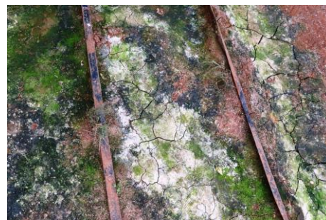
図5 ひび割れした様子 (マルチ除去4日後)
