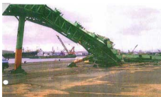
( 被災したコンベアー )
