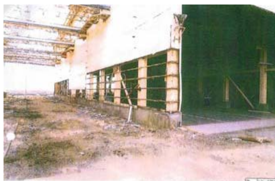
( 被災した施設 )
