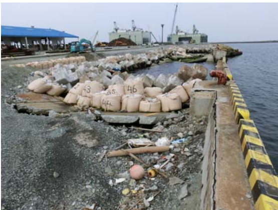
鋼矢板岸壁の倒壊
