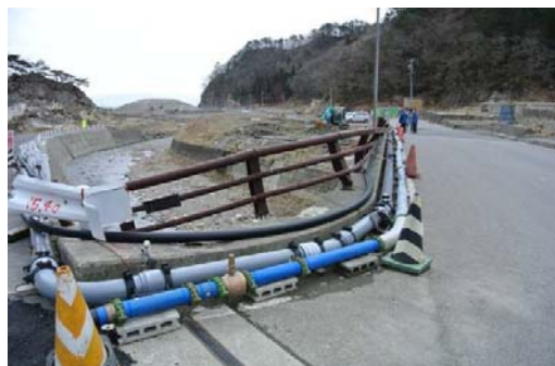
田野畑村島越橋仮設配管
