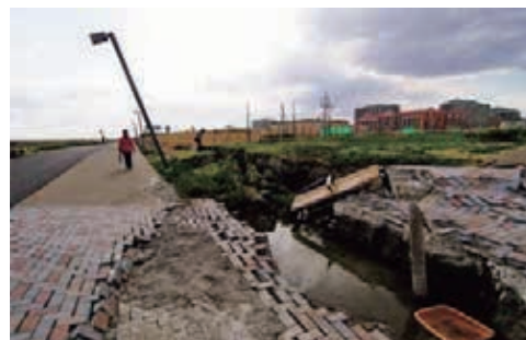
液状化現象（千葉県浦安市） 出典：内閣府ホームページ
