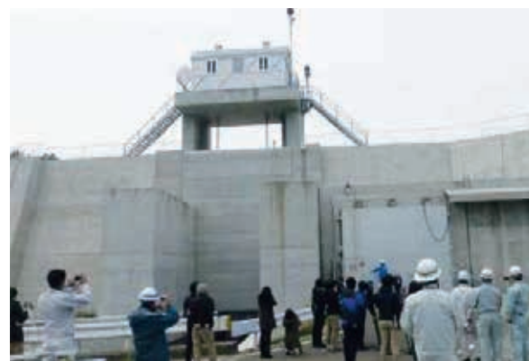
大船渡市合足農地海岸 水門・陸閥自動閉鎖システム
