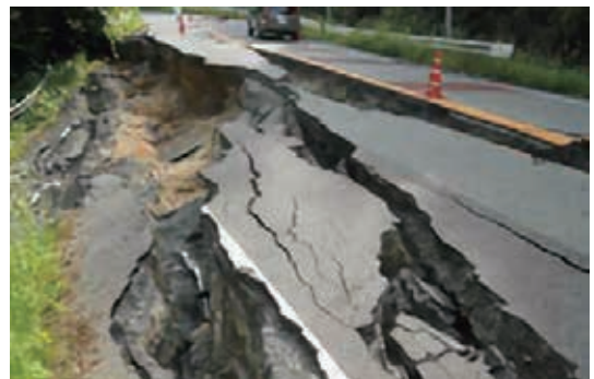
県道35号線の道路破損状況
