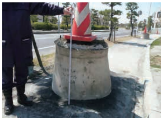
液状化によって突出した人孔（浦安市）
