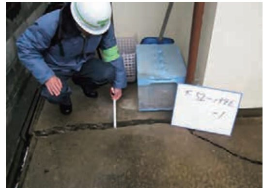
被災宅地危険度判定作業（仙台市）
